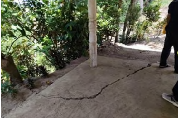
படம் 5m: தள எண் 232 அதிக அபாயம் உள்ள வீட்டின் விரிசல் விட்ட தரை
